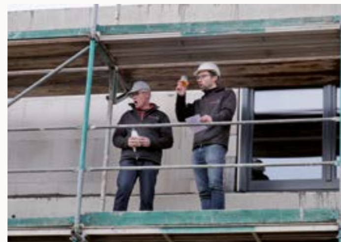
Bauführer Philipp Stöhr von der Schultheiss Hoch- und Tiefbau GmbH sprach den Richtfestspruch.
